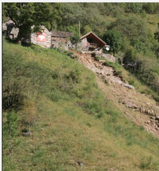
Fenomeni di erosione (A. Persico)
